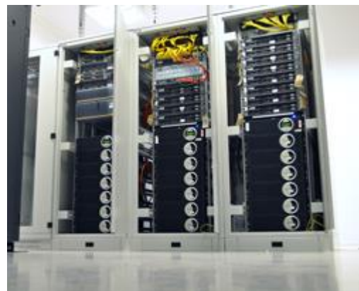
Rys. 7. Serwerownia w Centrum Zarządzającym w Warszawie.
